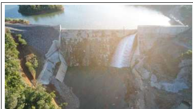
Foto 1 – Registro fotográfico com sobrevoo de drone, do dispositivo da vazão sanitária 100% aberto.
