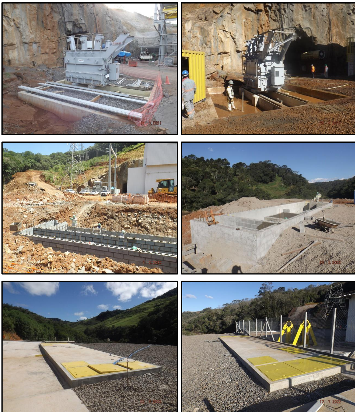
Figura 112 – Bacia coletora e caixa SAO do Trafo.
