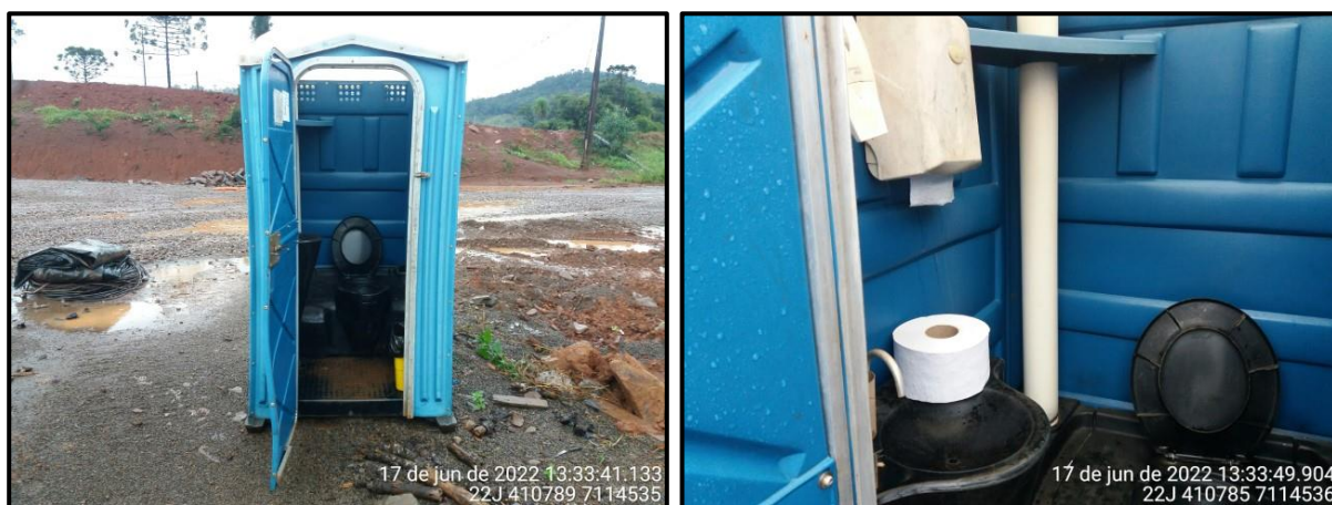
Figura 30 – Banheiro químico para apoio das equipes de desmobilização.
