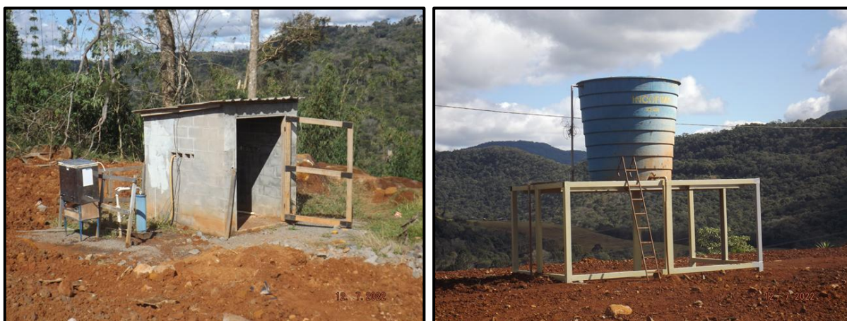
Figura 107 – Poço artesiano para fornecimento de água para a operação.
