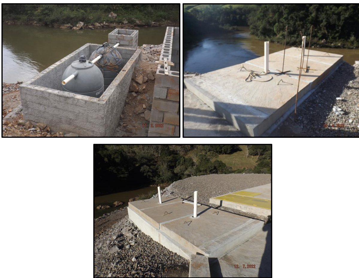
Figura 114 – Sistema de tratamento de efluente sanitário instalado.
