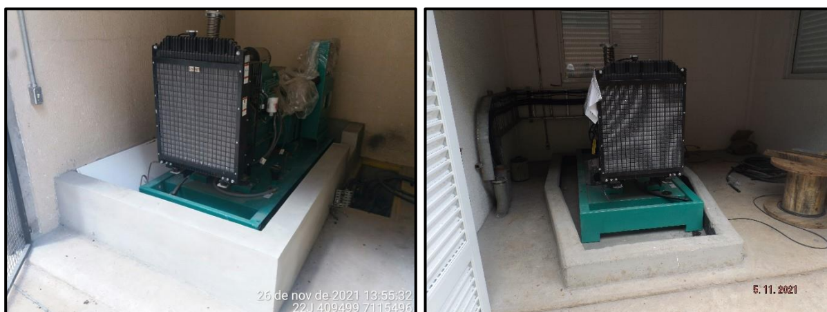
Figura 115 – Grupos geradores a diesel instalados na casa de força e tomada d'água.
